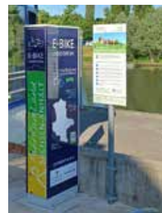
52 E-Bike-Ladestationen wurden im Land errichtet
