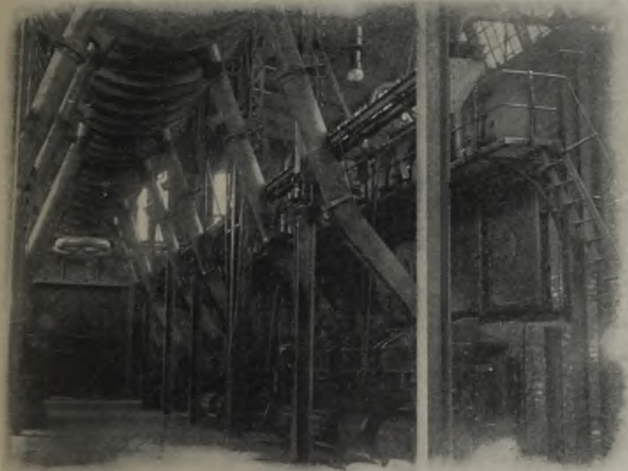
Abb. 10. Innenansicht des Kesselhauses.
